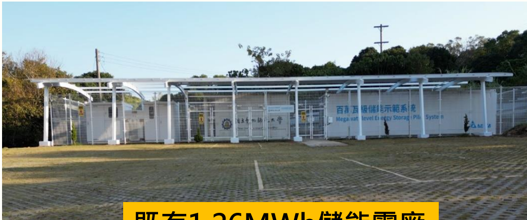
既有1.26MWh儲能電廠
